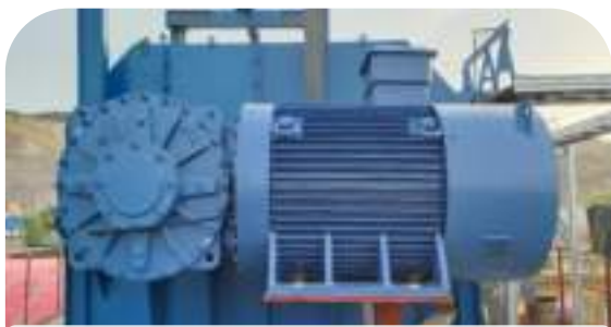
2×132kW 板链提升机【平邑中联】
